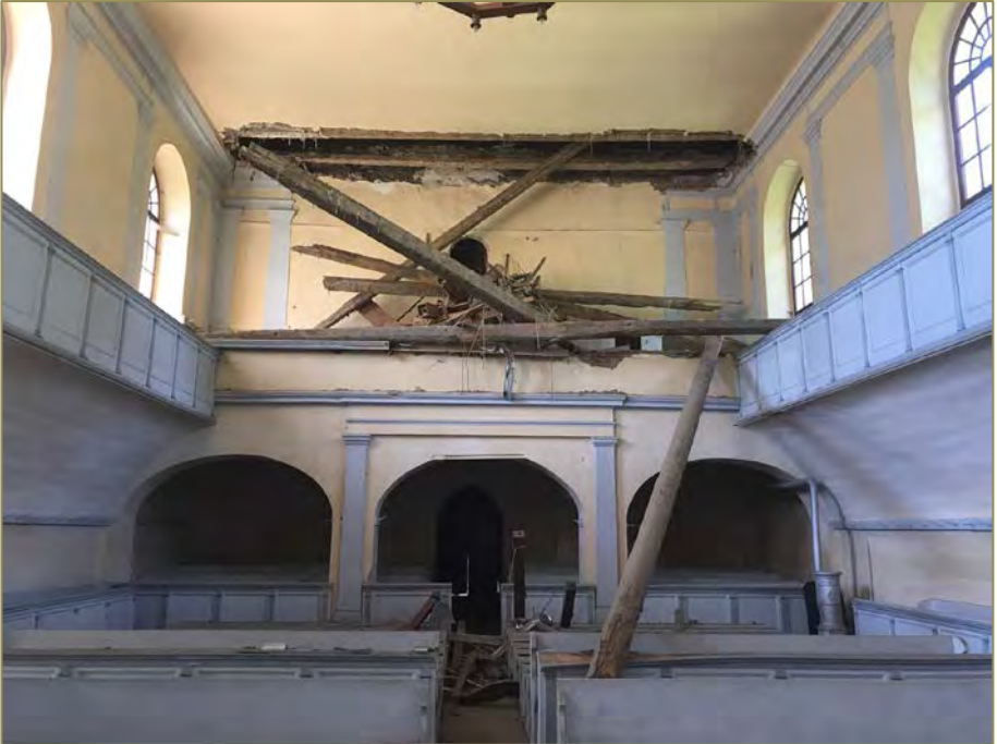
Die von Samuel Maetz 1807 erbaute Orgel in der Nadescher Kirche ist durch die herabgestürzte Kirchendecke zerstört worden. Foto: Ivan Erhard Laszlo
