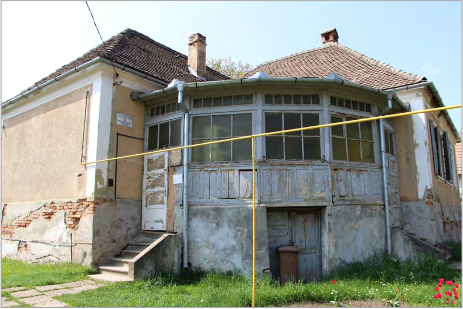
Der Dispensar im baufälligen Zustand 2013
