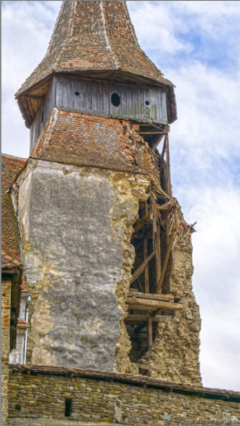
Eingestürzte Ecke am Kirchturm in Radeln
