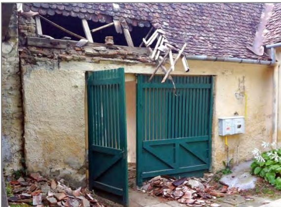
Eigestürztes Dach des Burgtores am 28. 8. 2013 Foto: H. W. Henning
