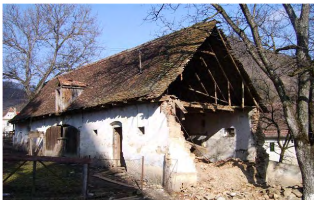
Eingestürzte Wand am Stall des Pfarrhofes
